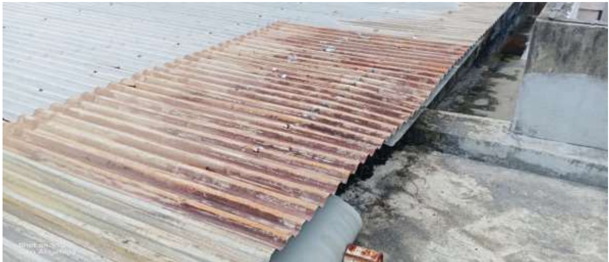
Rekahan Pada Dinding Bumbung
