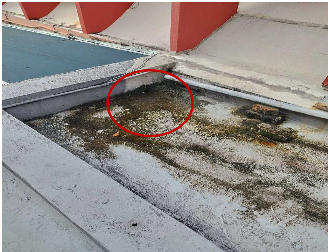
Gambar Atas : Punca – Kebocoran bumbung (depan bilik AV)
