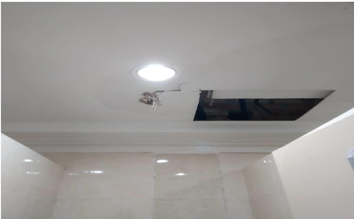
Gambar Diatas : Siling menjadi rosak & pecah kerana air bertakung di atas siling
