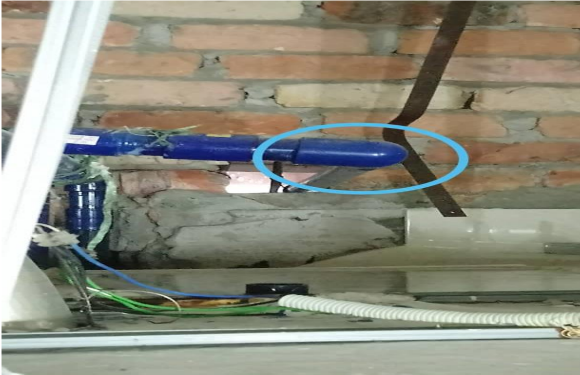
Gambar Diatas : Soket paip bocor – siling bertakung
