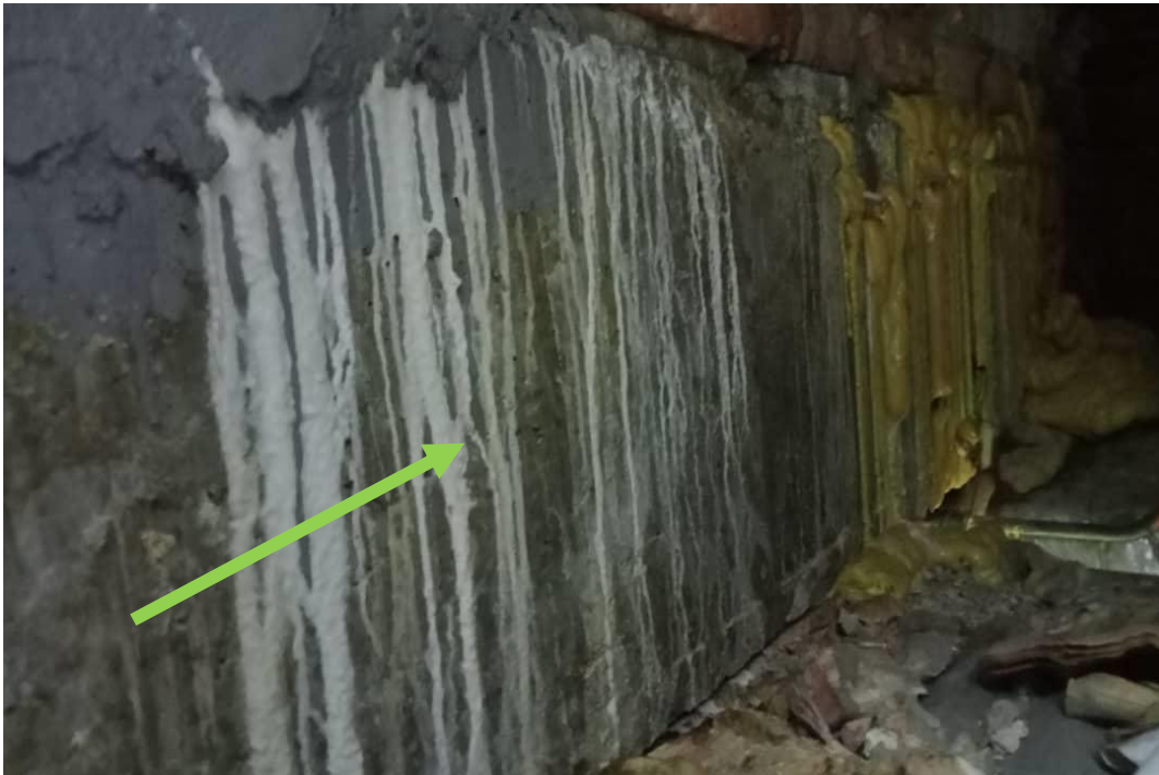
Gambar diatas : Kebocoran berlaku. Air dikenalpasti keluar daripada dinding ( Kawasan putih)
