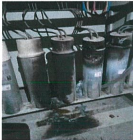
Gambaran Capacitor Bank di papan suis utama yang terbakar
