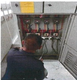
Gambaran Semakan oleh Kontraktor Elektrik di blok M&E
