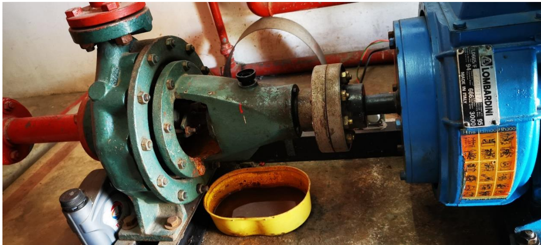
Standby Pump ( Pump Diesel)
