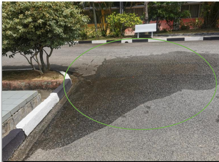
Kesan Air Akibat Paip Bomba Bawah Tanah Pecah
