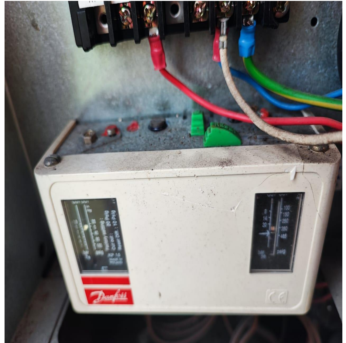
Kerosakan pada contactor air-cond dan tiada lagi alat ganti
